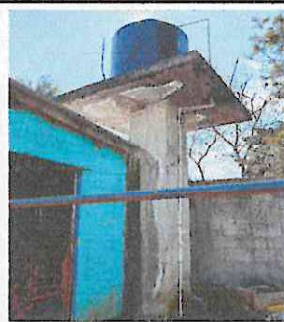
Foto 12: Sustitución de depósitos de agua 1,000 lt no sirve se encuentra en mal estado.
